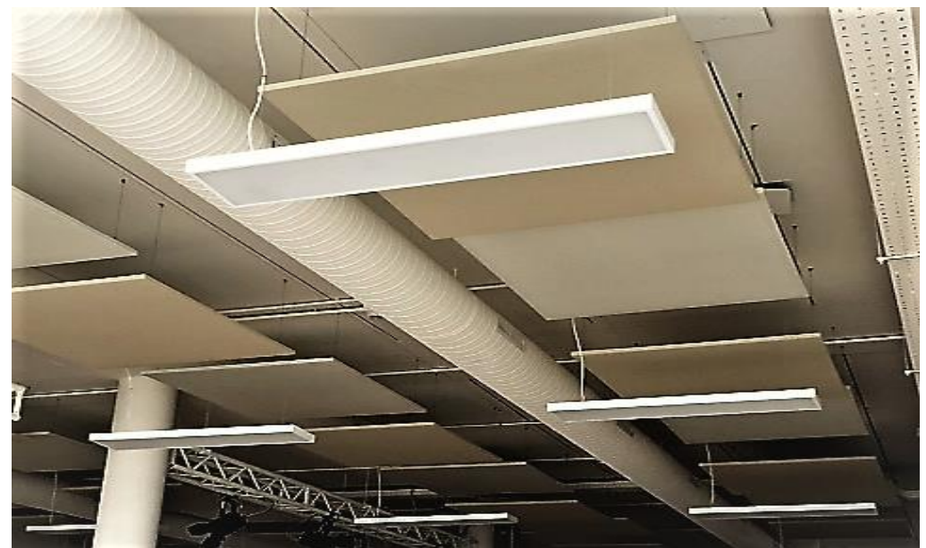
Gadames 57 – con particolare pannelli fonoassorbenti
